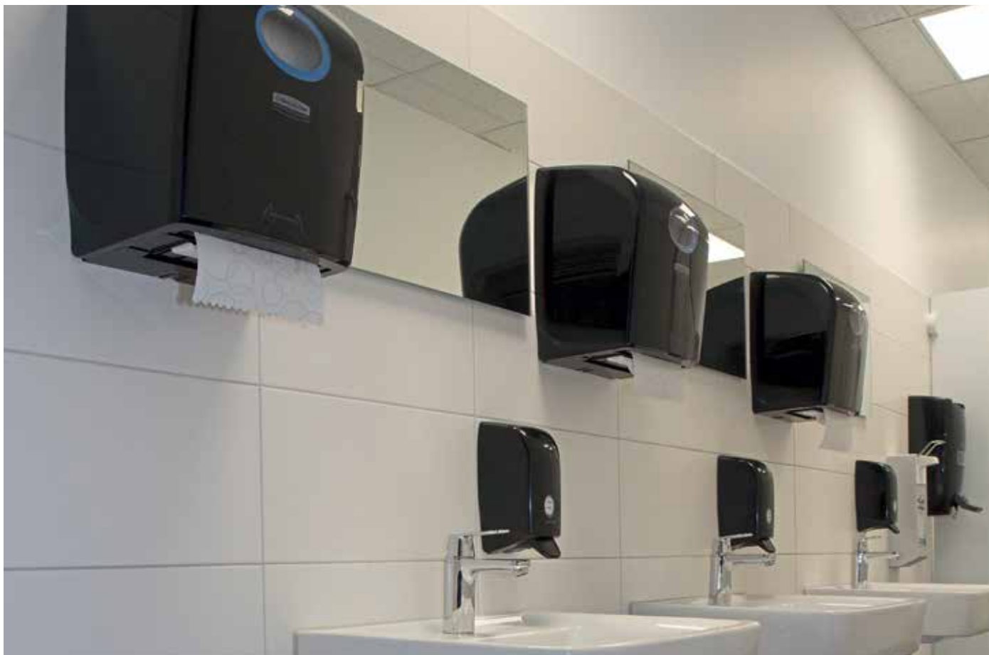
Mit einem effizienten Rollenhandtuchsystem, das sich an der Besucherfrequenz orientiert, verringert sich der Nachfüllaufwand für Reinigungskräfte.
